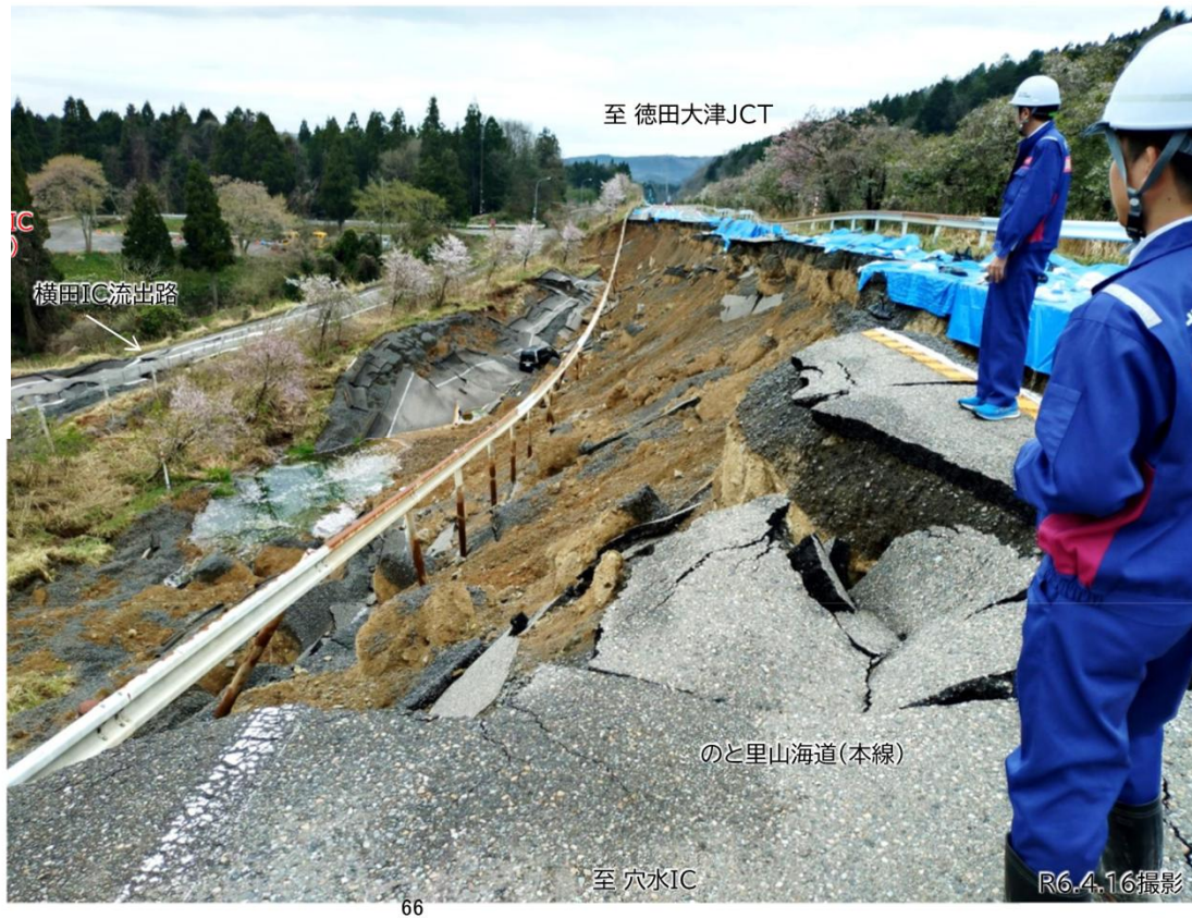
のと里山海道の盛土被害 (北陸地方整備局HP)
