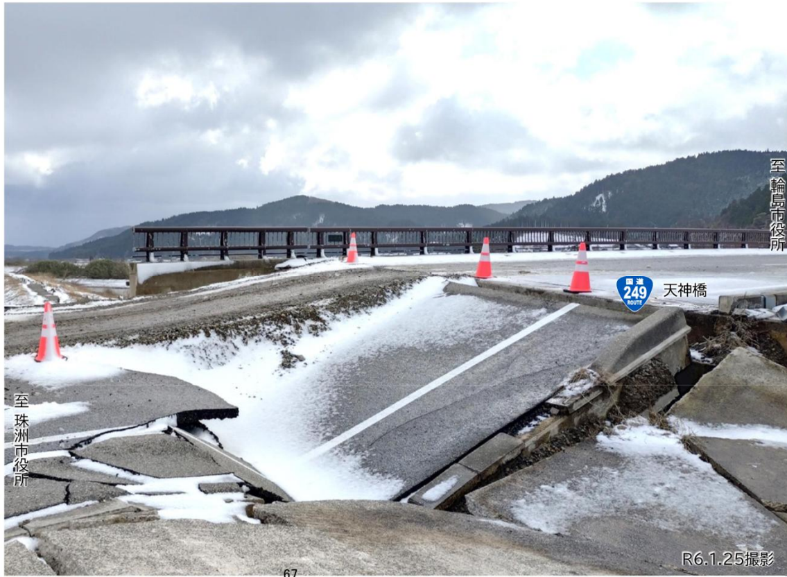
国道249号の被害（輪島市） （北陸地方整備局HP）
