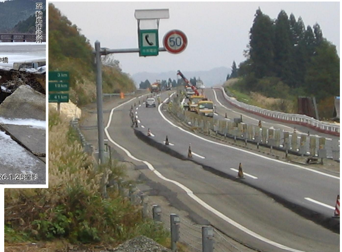
関越自動車道の被害（中越地震） （NEXCO東日本提供）
