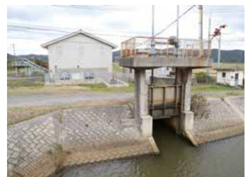
掛戸排水機場と水門 排水機場には常時排水用ポンプ1台、洪水時排水用ポンプ2台が整備されている
